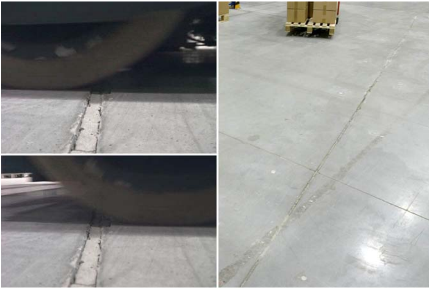
Obr. 6 Žádný pohyb dilatačních celků při pojezdu skladovací techniky, pohled na část opravené desky podlahy
