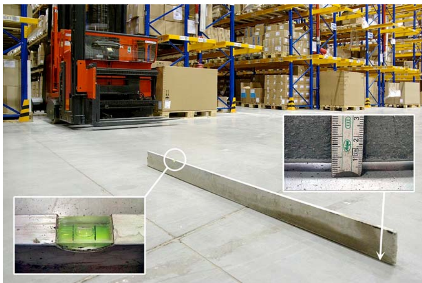
Obr. 1 Zkroucené okraje dilatačních celků betonové podlahy ve skladovací hale
